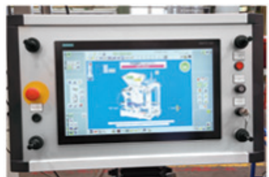
Panel de operación
