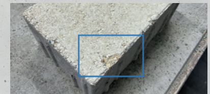
Fehlermarkierung blau: Ausbruch
