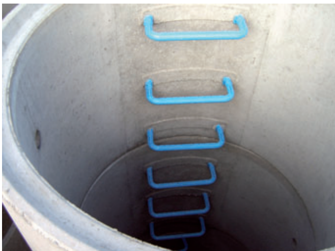
Schachtringe mit Steigbügel
