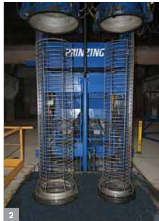
Stabile Stahlkörbe für die Rohre und Schachtringe, produziert auf einer neuen MBK Bewehrungsschweißmaschine
